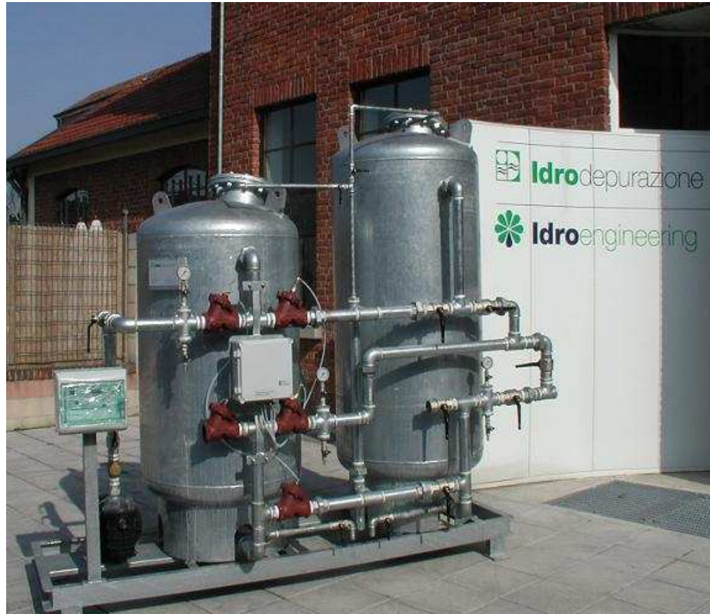
Impianto di riutilizzo - Portata 10m 3 /h (filtro a sabbia automatico e filtro a carbone attivo manuale)
